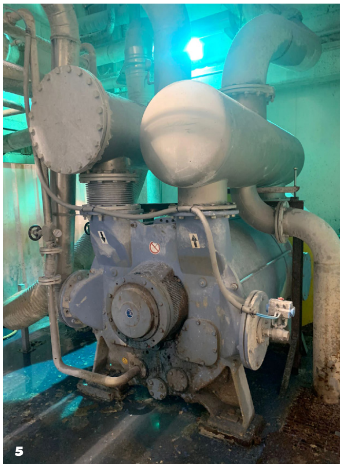
5 Una visione di insieme della pompa del vuoto
